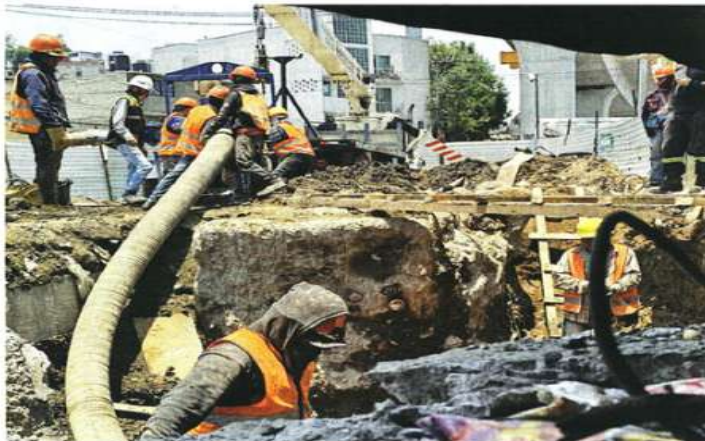
FIGURA. Los trabajos de perforación para la obra del Tren provocaron que una tubería resultara dañada en la Alcaldía Álvaro Obregón.
