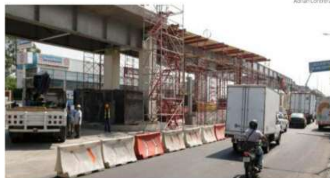
Estructura incompleta de uno de los tramos del trolebús elevado, a la altura del Penal de Santa Martha Acatitla.
