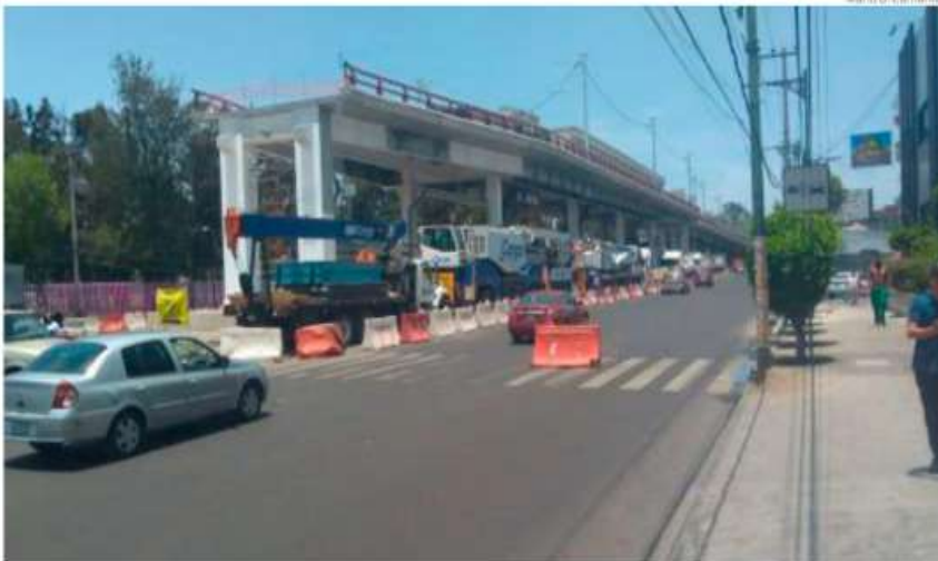
En la estación Deportivo Santa Cruz falta una trabe de unos 30 metros que no hay fecha para su colocación.
