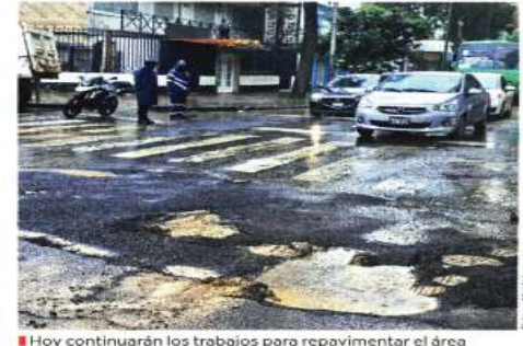
Hoy continuarán los trabajos para reparar el área donde ocurrió la fuga, en la Colonia Educación.
