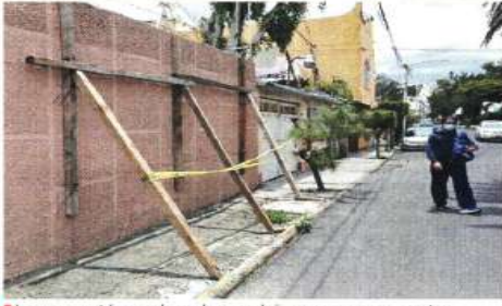
La zona está acordonada por el riesgo que representa.
