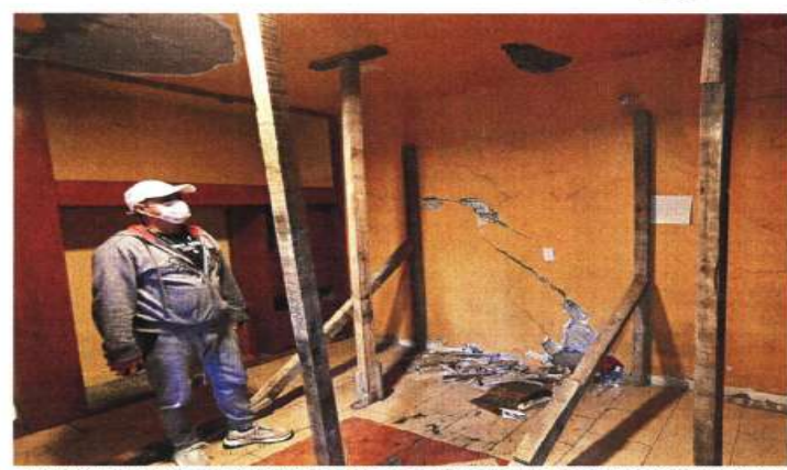
Desde el 15 de marzo, 30 inmuebles de la colonia registran daños, ocho tienen daño estructural.
