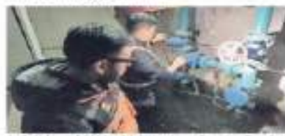
Trabajadores del Metro laboraron, con el agua en las vías, para solucionar el problema de la inundación en vías.
