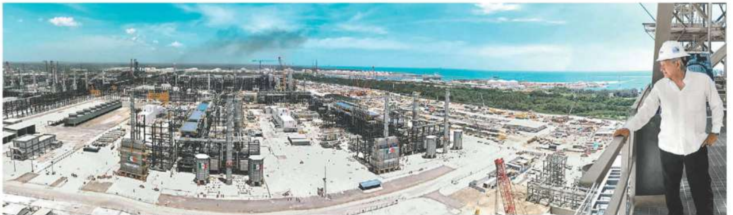
El Presidente subió a una torre de la planta de Pemex en Tabasco para supervisar los avances. ESPECIAL
