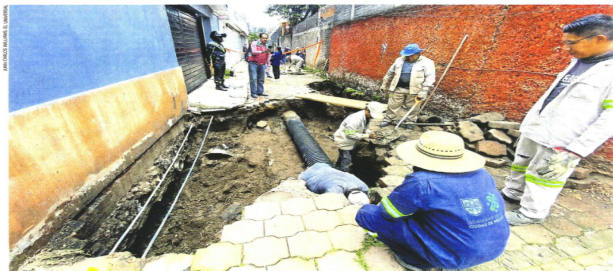
El socavón que se abrió en la alcaldía Xochimilco tiene cinco metros de largo y tres de profundidad.
