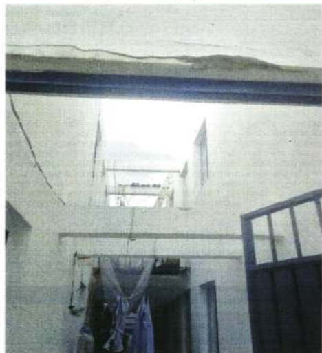
Los habitantes aseguran que han aparecido grietas, incluso, que algunos departamentos registran desprendimientos.
