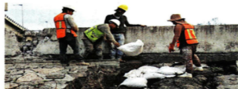
La oquedad de más de un metro y medio de profundidad fue sellada con grava y tepetate.
