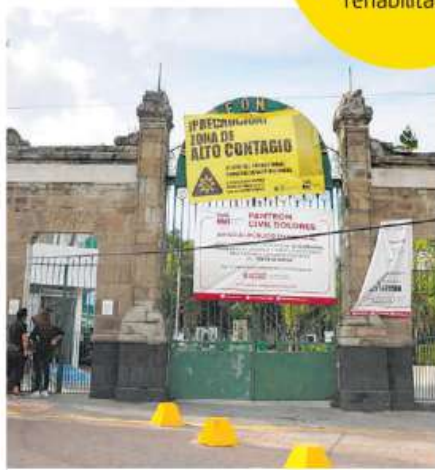
Se demolerá la barda perimetral del Panteón de Dolores por su mal estado
