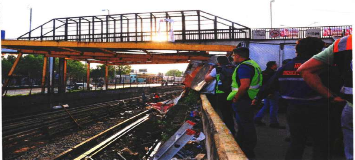
El camión impactó un puente peatonal y posteriormente cayó a las vías. El conductor murió en el hospital por las lesiones.
