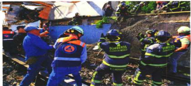
Durante la mañana y tarde del martes se realizaron trabajos para retirar el tráiler y el puente dañado.
