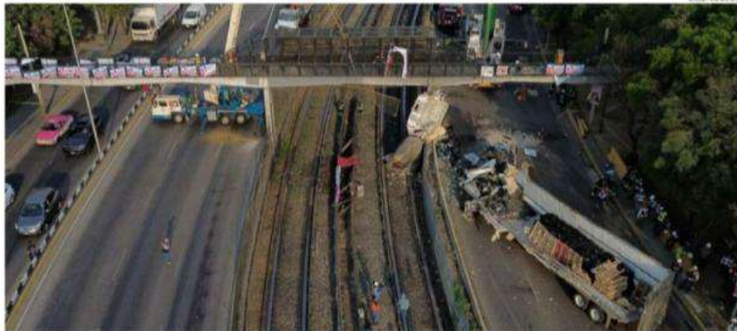
Con apoyo de alrededor de 150 personas y un equipo compuesto por 4 grúas de alta capacidad y 4 grúas de brazo hiab, se realizaron las tareas de remoción.
