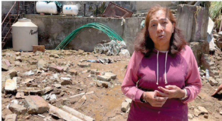
ISABEL AVILÉS, sobre restos de una parte de su casa que quedó severamente deteriorada y enlodada, ayer.
