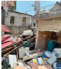
LLUVIAS OCASIONARON que una barda de la casa de Isabel cayera.
