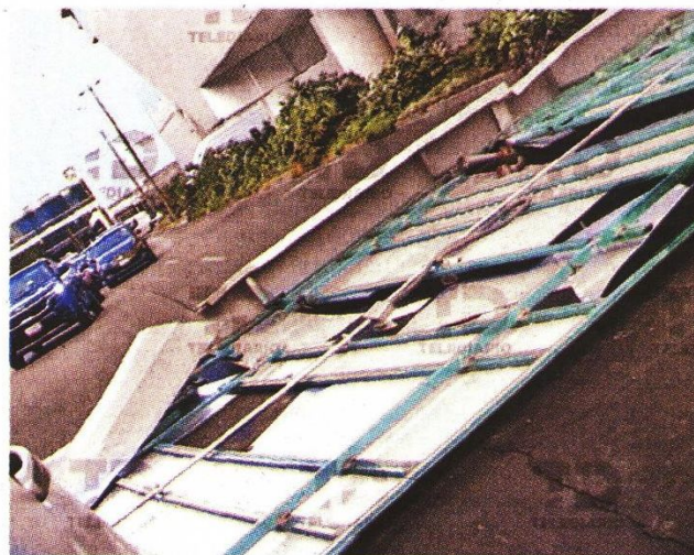
Daño a puente peatonal frente a la Terminal 1. ESPECIAL
