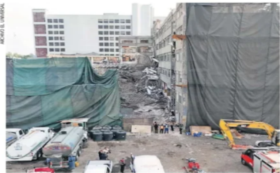
El inmueble de San Antonio Abad 124 que colapsó el 9 de marzo y dejó un saldo de tres personas fallecidas contaba con un acuerdo de facilidades.
