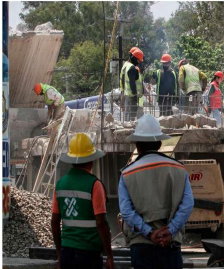
Trabajadores laboran para remover los escombros en el tramo accidentado de la Línea 12.
