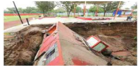
Las construcciones colapsaron ante el socavón que se abrió el sábado pasado en el deportivo de la Gertrudis Sánchez.
