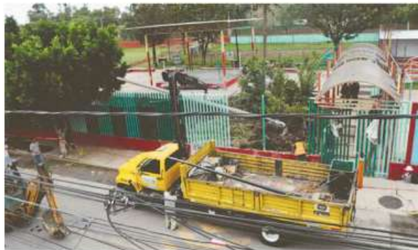
El deportivo permanecerá acordonado durante la reparación
