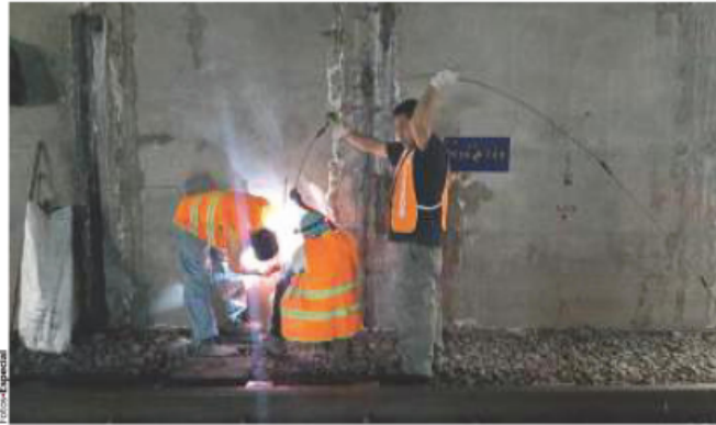
EL AVANCE general de obra, en el tramo subterráneo de 11.8 kilómetros, lleva 20 por ciento.
