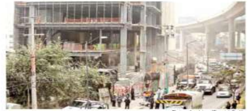
Cuatro pisos ya le fueron retirados al edificio de Periférico Sur 3042. Foto: Archivo/David Solís
