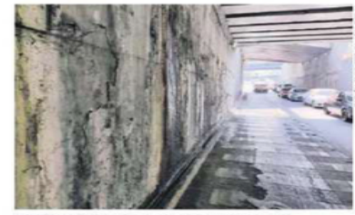
Las filtraciones de agua son notorias en el bajopunte de Calzada de Tlalpan y Tasqueña.
