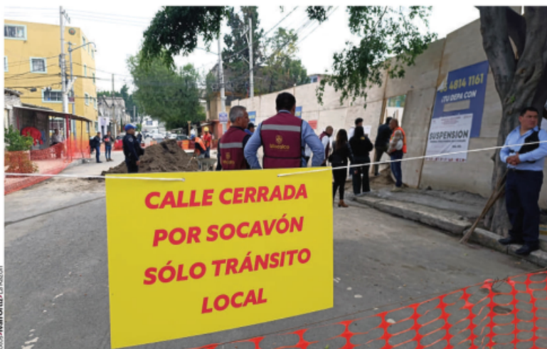
LA ALCALDESA de Iztacalco, Lourdes Paz, encabezó un recorrido ayer en el predio Vainilla 234, donde la empresa Grupo UBK Inmobiliaria S.A. de C.V. causó un socavón el pasado 3 de junio.
