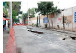
LA ALCALDÍA informó sobre el socavón en la calle, el pasado lunes.
