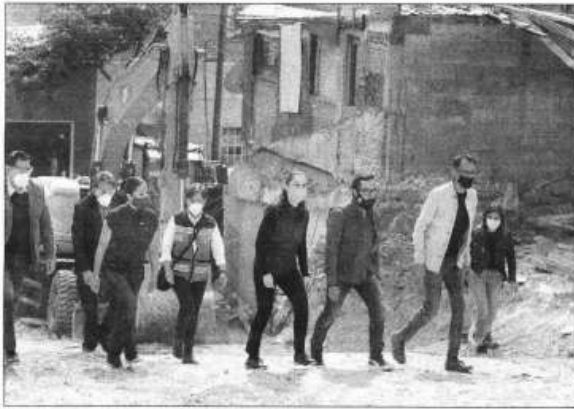
▲ La jefa de Gobierno, Claudia Sheinbaum Pardo, encabezó el acto protocolario de inicio de los trabajos de demolición Foto Pablo Ramos
