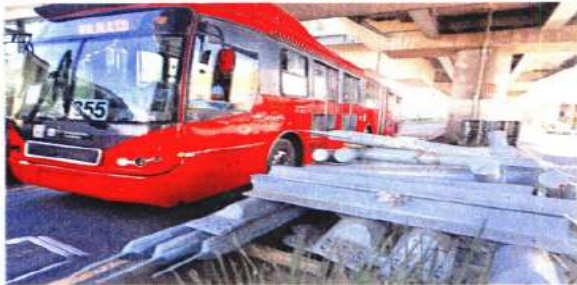
Para reforzar el tramo elevado de la Línea 12 del Metro, que colapsó de Oltres a Tezco hace casi dos años, se requirió la fabricación de 33 mil piezas de acero.
