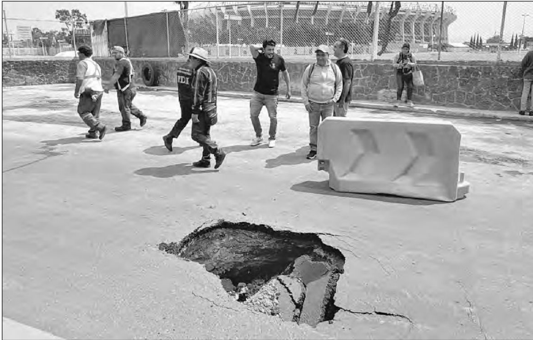
▲ A menos de 100 días de que comience la justa mundialista de futbol, un enorme socavón se abrió a un costado del estadio Azteca debido a deficiencias en la infraestructura hidráulica. Foto Alfredo Domínguez
