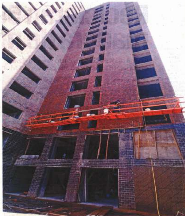
En un recorrido por el edificio de 15 pisos se pudo observar que la estructura está concluida, pero aún están pendientes puertas y ventanas tanto adentro como afuera.
