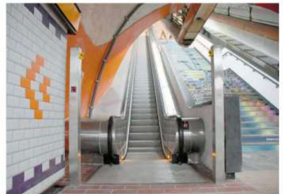
Instalaron dos nuevas escaleras eléctricas en líneas 3 y 7 del Metro / FOTO: CORTESÍA STC
