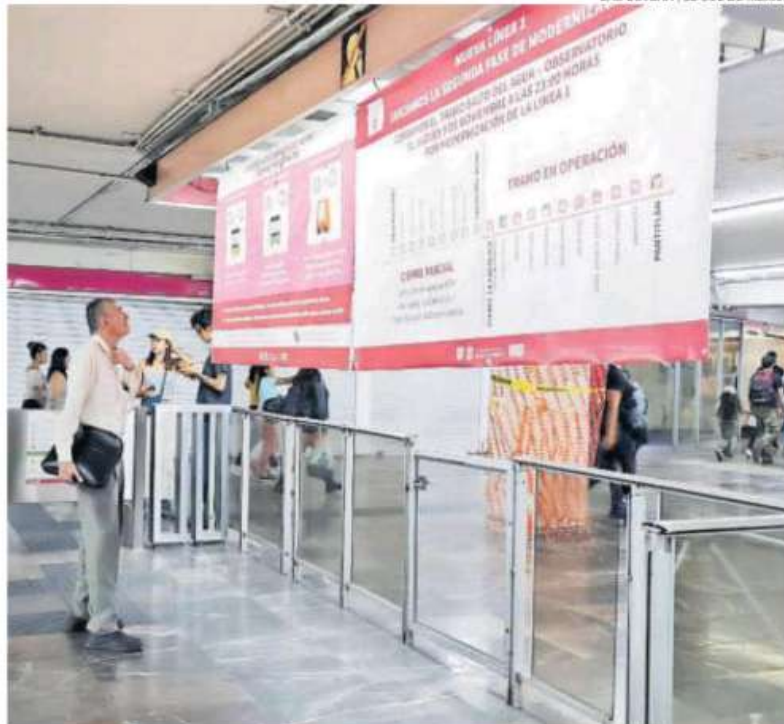
Salto del Agua operará como punto de armado y acopio de materiales
