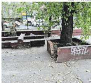
Sus jardineras están deterioradas
