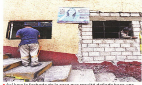
Así luce la fachada de la casa que resultó dañada hace una semana por el impacto de un camión que derrapó.
