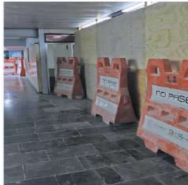
El tramo de Línea 1 de Balderas a Observatorio cumple este 9 de mayo seis meses cerrado por obras de modernización.
