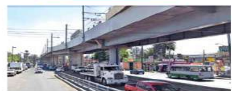
Fotos: Especial y Tomada de Google Maps. Entre la zona cero y la estación Tezonco hay un tramo similar al que colapsó, el cual será desmontado y reforzado.
