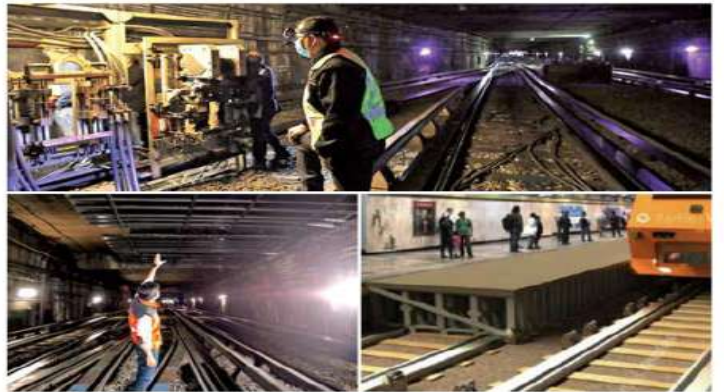
Los técnicos revisan el sistema eléctrico que será cortado el sábado (arriba); la zona del respiradero, por donde entrará el material (izq.); y un render de cómo quedará el andén ampliado (der).
