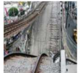
Estaban mal soldados.
