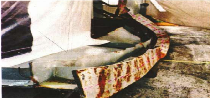
Fotografía que muestra el pandeo de la viga sur en la Línea 12 que colapsó, el pasado 3 de mayo, después de que se retiró la cubierta de concreto. Es uno de los elementos principales que aparecen en el Informe final.
