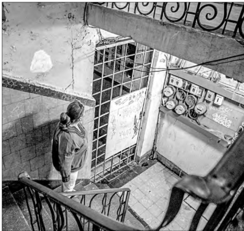
◀ Propiciar el deterioro del edificio Beatriz, en avenida Insurgentes Sur 385, es parte de la estrategia de la inmobiliaria Escalera Náutica SA de CV para desalojar a la última familia que reside en el inmueble. Foto Jair Cabrera Torres
