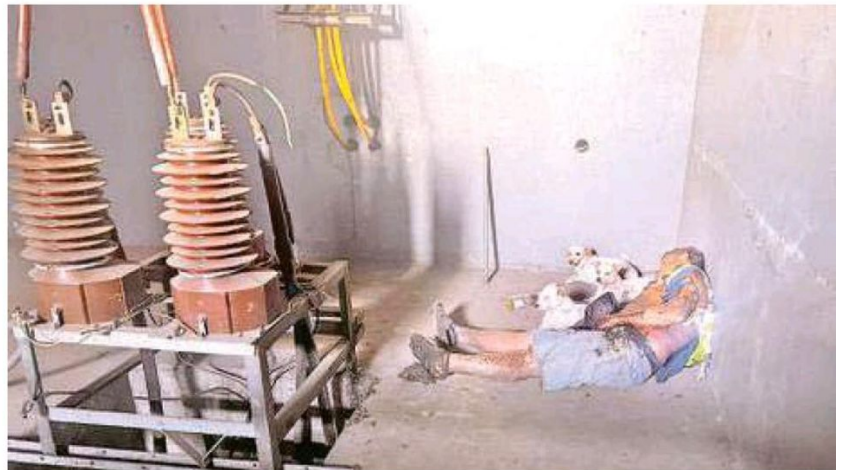
El hombre , de alrededor de 30 años de edad, ingresó a la subestación del Metro para, presuntamente, robarse cableado del lugar /FOTOS: LUIS A. BARRERA
