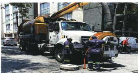
En un edificio de la Del Valle, así sale el agua de la toma de calle, antes de ingresar a la cisterna.
