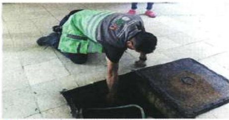
Paralelo a los estudios, en Nonoalco se realizan labores de desazolve en la red de drenaje.
