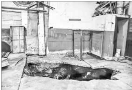
◀ Dentro de un predio de la colonia Lomas de San Lorenzo, en Iztapalapa, se formó un socavón de unos 15 metros de diámetro y tres de profundidad. Foto La Jornada
