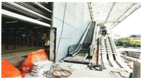
Los usuarios ascenderán por seis escaleras eléctricas y seis fijas para llegar a la zona de andenes.
