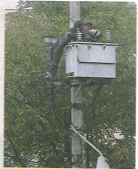
Recibe fuerte descarga eléctrica y muere, en la colonia Granjas San Antonio, Alcaldía Iztapalapa
