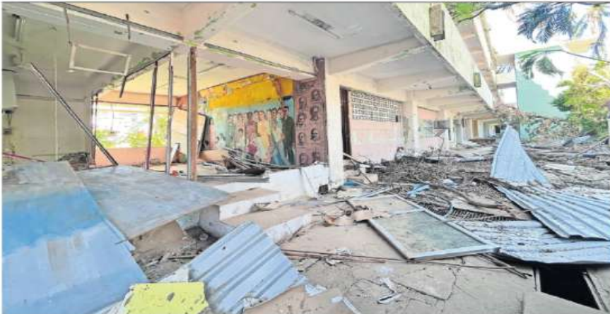
Escuelas como la Federal 1, en Acapulco, resultaron severamente dañadas por el huracán del 25 de octubre. Aún permanecen los escombros en las aulas y no hay todavía plan de restauración ni fecha de regreso a clases.
