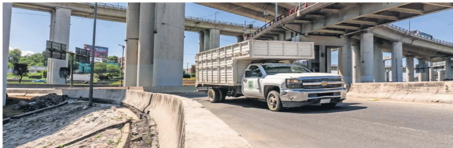
La grieta fue reparada por la alcaldía y personal de la Secretaría de Gestión Integral del Agua (Segiagua). Se rellenó con tepetate, que es lo recomendado, informó el director de Servicios Urbanos de Iztapalapa.
