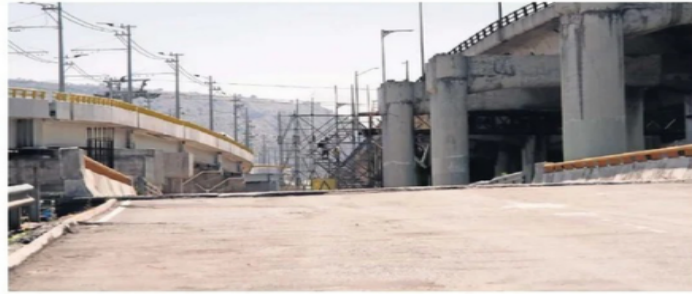
En la zona de La Concordia se pudieron observar dos grietas más: a unos metros hacia el Estado de México, una en el suelo y otra en la intersección superior de un puente.
