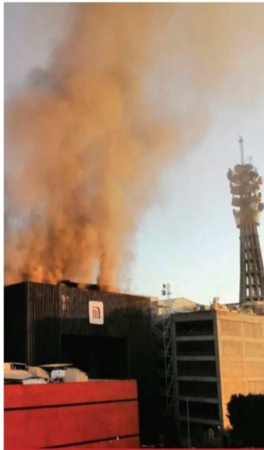
El siniestro comenzó a las 5:48 de la mañana en la Subestación Eléctrica de Luis Moya.
