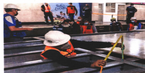
El parámetro de diseño de esta infraestructura es de 800 kg por metro cuadrado, lo que permite tener mayor soporte de usuarios.
