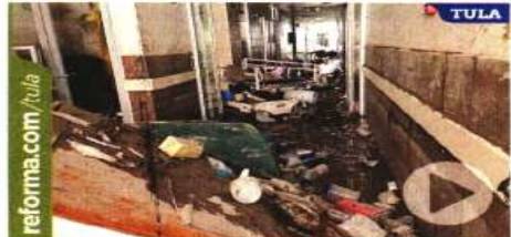
El hospital del IMSS en Tula quedó destruido. Autoridades del Instituto iniciarán hoy su rehabilitación.
