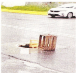
Huacales fueron colocados para advertir a los conductores del riesgo; sin embargo, algunos ya han padecido afectaciones en sus unidades.
