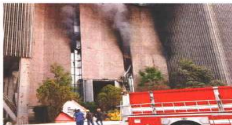
El sábado pasado se incendió la subestación eléctrica Buen Tono, lo que dejó fuera de funcionamiento seis líneas del STC Metro.
