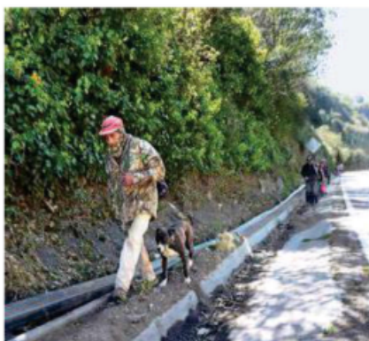
Una tubería lleva el agua hasta el tanque La Pila
