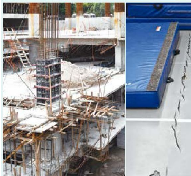
CASO. El alcalde Luis Mendoza apuntó que las obras en el predio de División del Norte 2325, generan el desprendimiento de paredes y fisuras en el Gimnasio Eduardo Gorraez y una parroquia.
