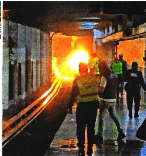
La L2 del Metro fue suspendida de San Antonio Abad a Viaducto por un cortocircuito, informó su director.
