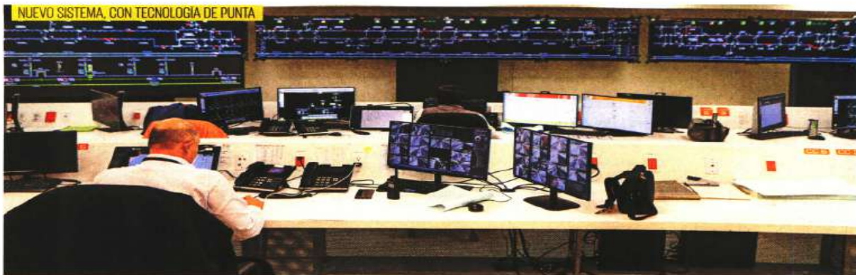
Los tableros están ubicados juntos para el monitoreo de las líneas 3, 4, 5 y 6; a un costado están aquellos que supervisan la Línea 2 y aparte se sitúan los de la Línea 1.
