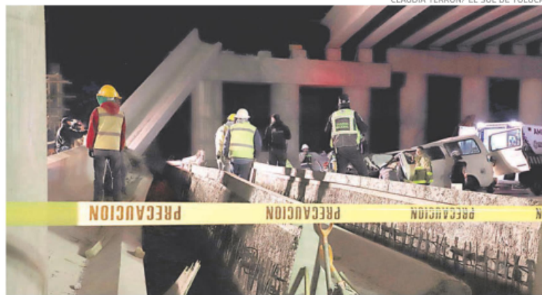
Caída puente de Tecamac.
