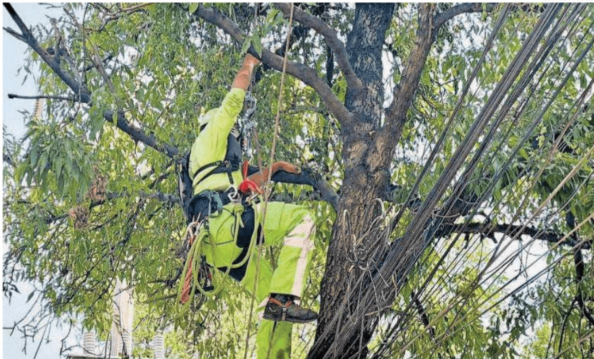
Las ramas de los árboles muchas veces interfieren con las líneas de transmisión de la CFE, por lo que deben ser cortadas
